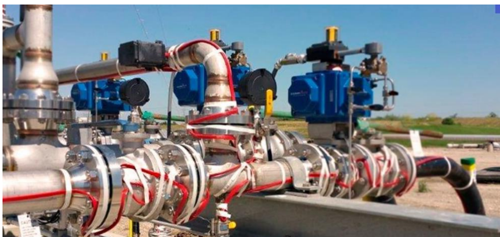
Рисунок 7 - Обогрев трубопровода греющим кабелем
