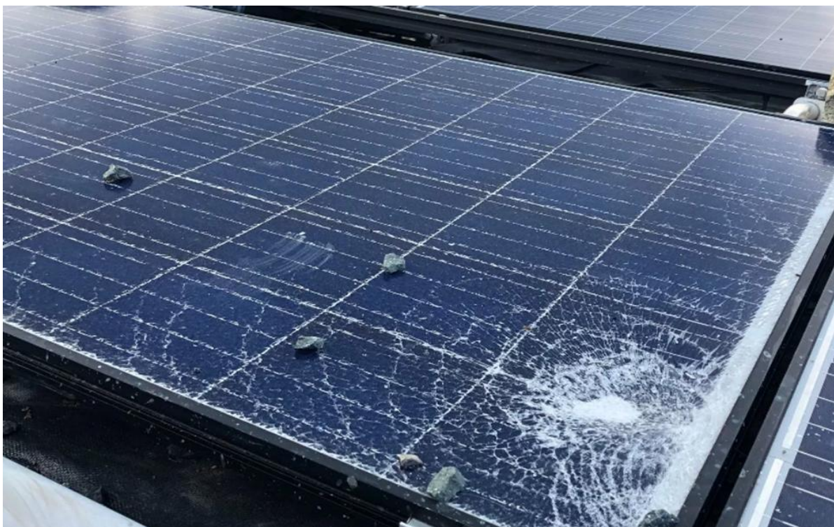
Рисунок 6. Повреждение панелей камнями.
